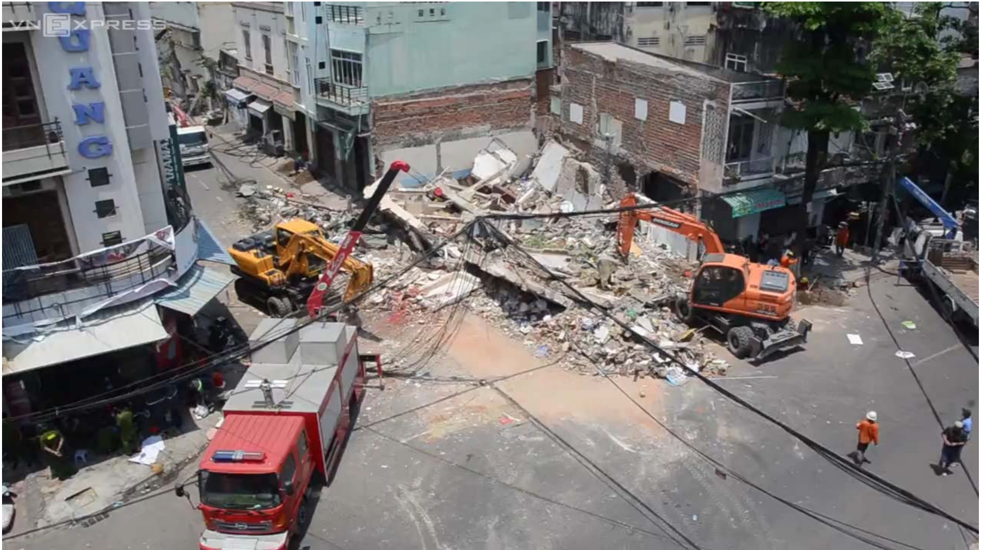
Sáng 20/04/2017, Quy Nhon, đào móng sập nhà
