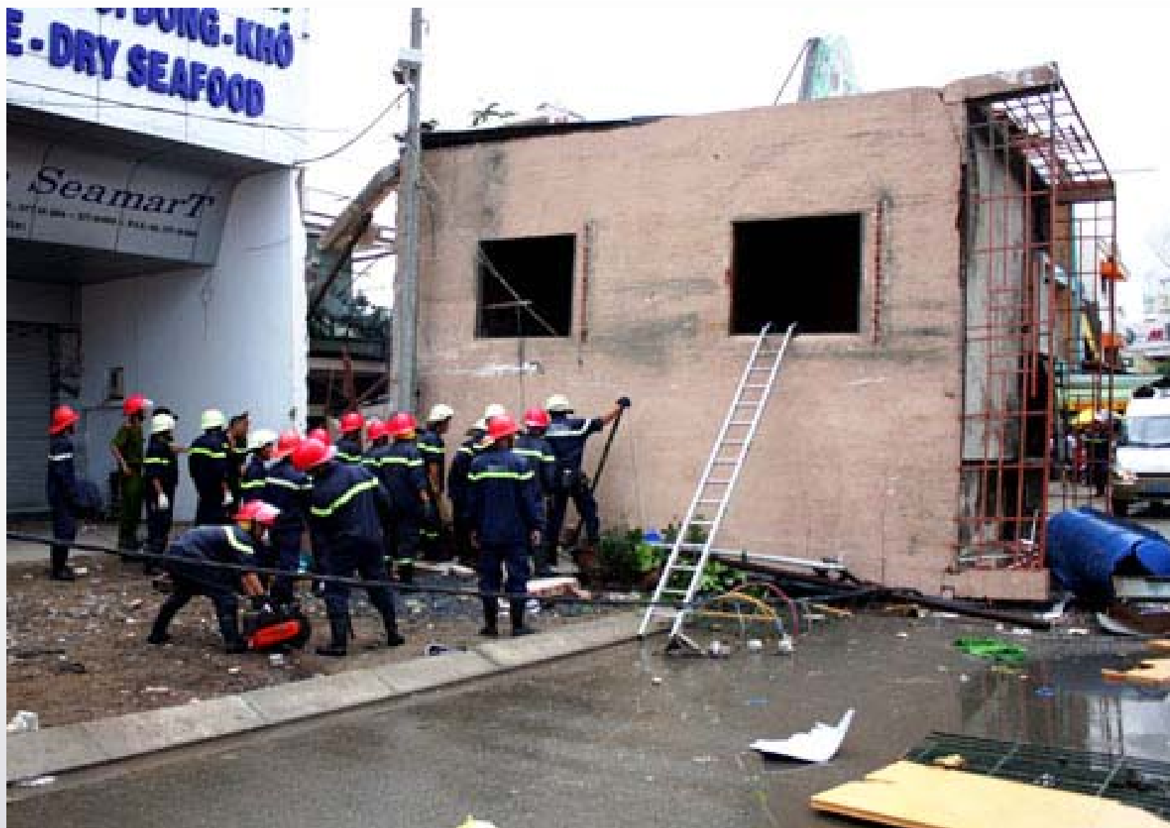
Nâng tầng gây sập nhà tại Q.7, Tp.HCM
