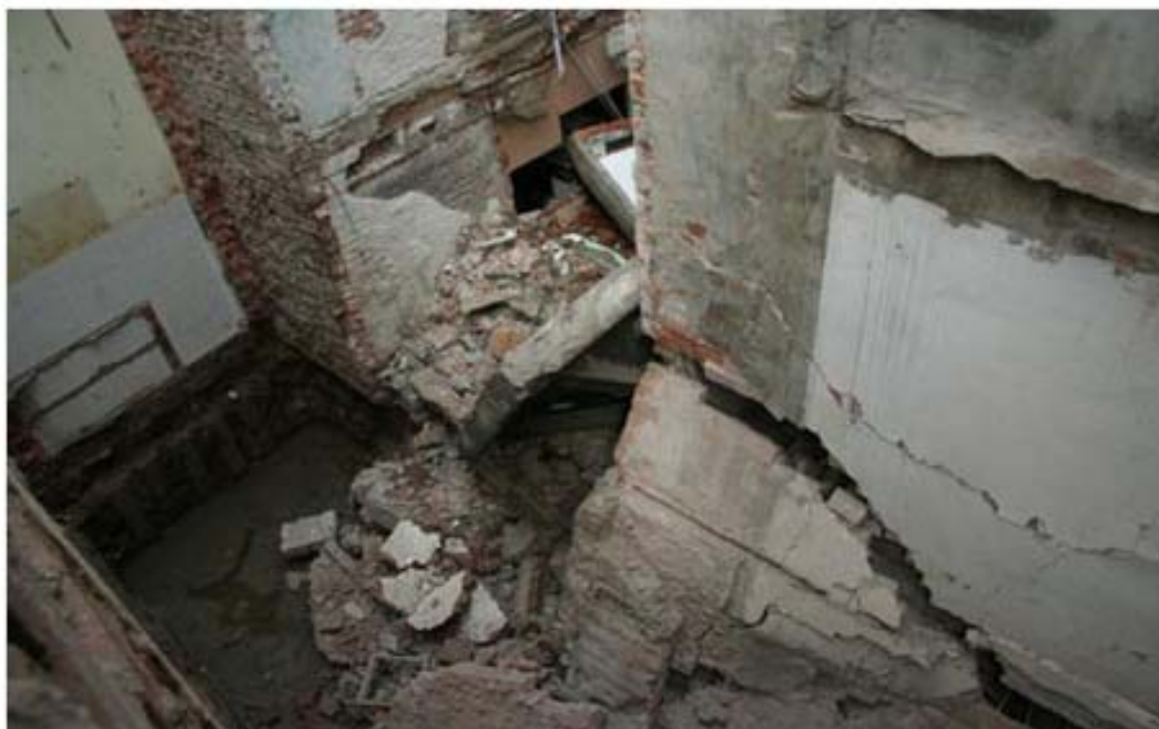
Cột giằng móng của ngôi nhà 91B đã bị gãy, tầng 1 bị sập tường, nứt toác.
