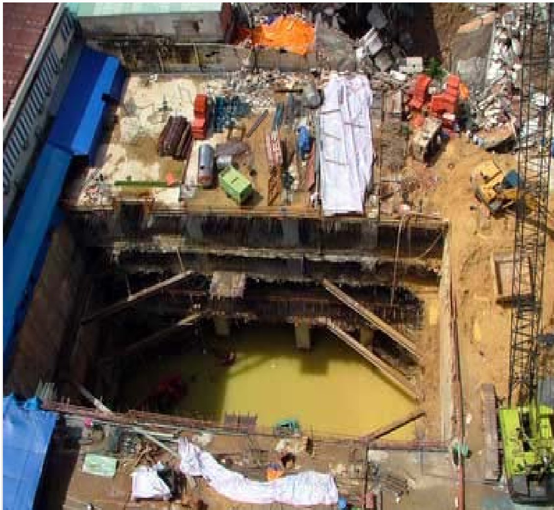
Sập tại Pacific Tower 09/10/2007
