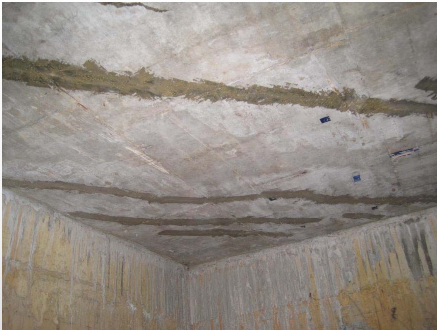
Nứt hầm khi thi công topdown
