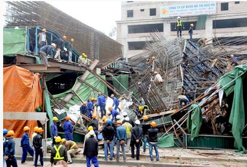
Sự cố sập đổ tại một công trình
