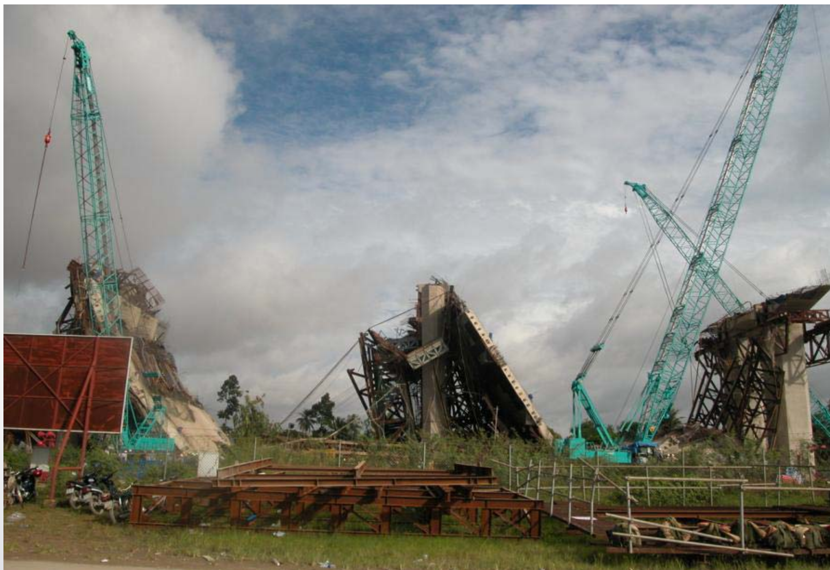
Sự cố sập đổ cầu Cần Thơ năm 2007
