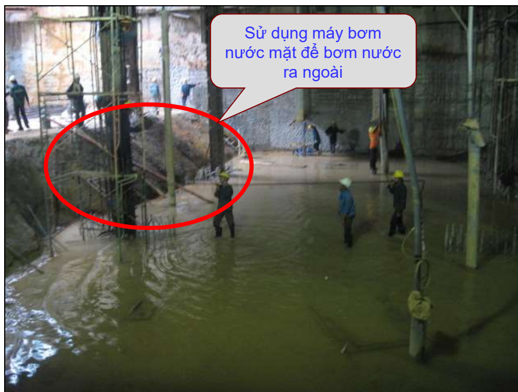
Nước ngầm dâng lên làm ngập tầng hầm
