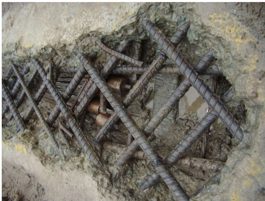
Đầu neo chết không đủ chiều dài neo → đầu neo chết bị tụt khi căng cáp
