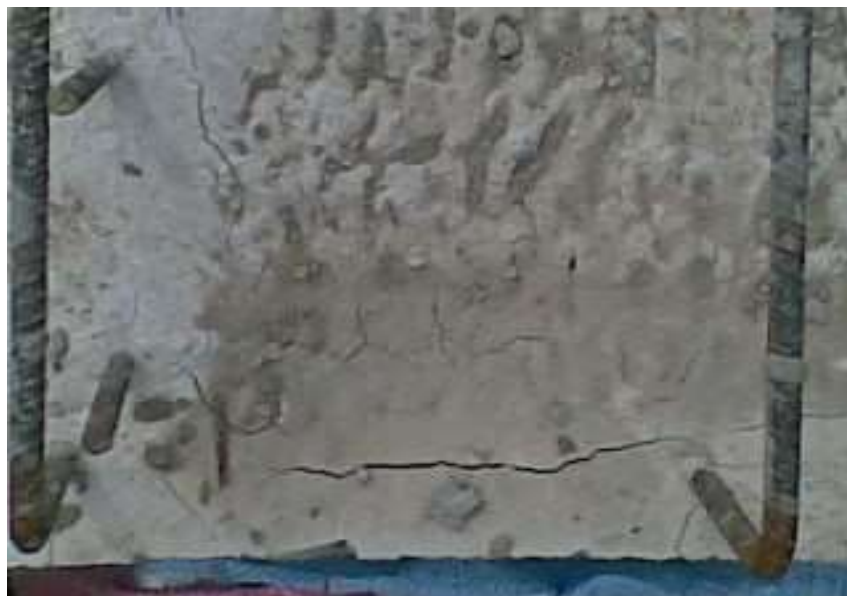
Vết nứt do không đặt thép chống nứt
