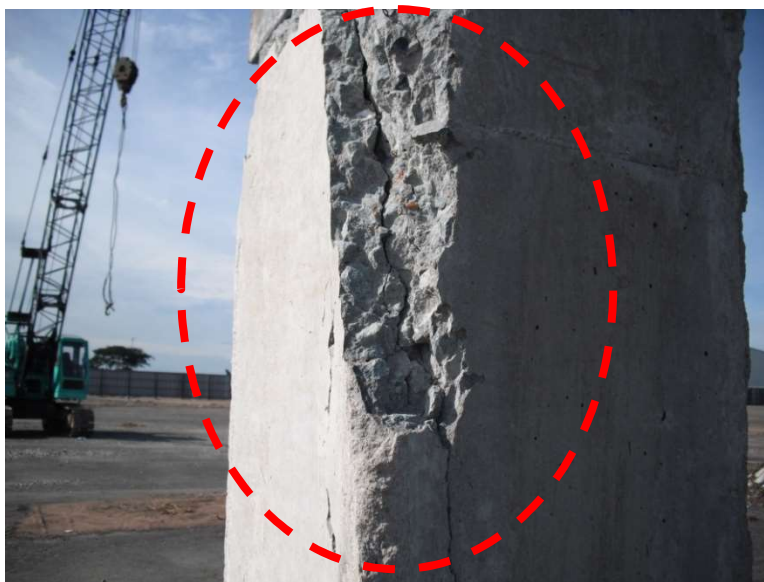
Cọc bị bể đầu do Chọn búa không phù hợp
