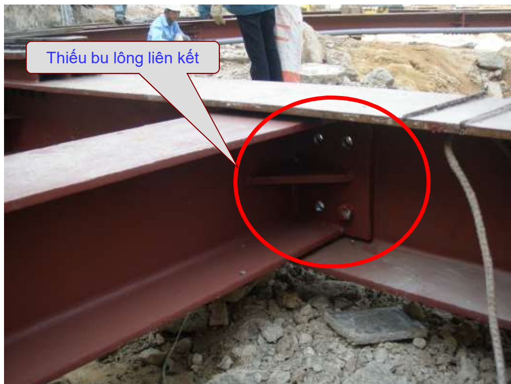
Lắp thiếu bu lông liên kết
