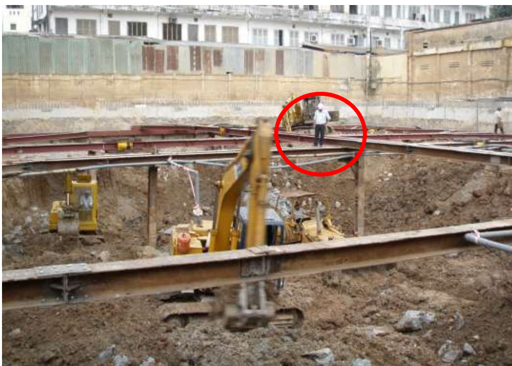
Thiếu bảng cảnh báo và hệ thống dây cứu sinh an toàn
