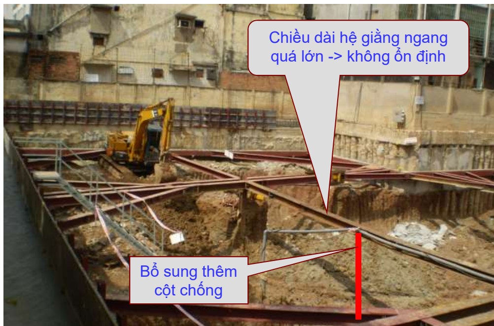
Chiều dài của hệ giằng chống ngang quá lớn
