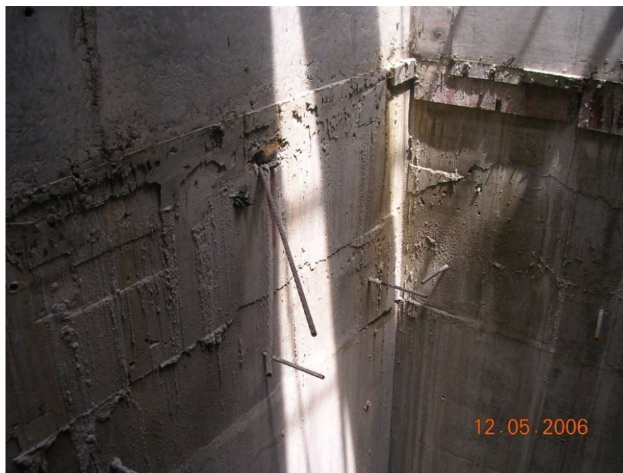
Các đầu neo sống vào lõi thang bị công nhân cắt nhầm cáp khi tháo sàn thao tác → không tiến hành căng cáp được
