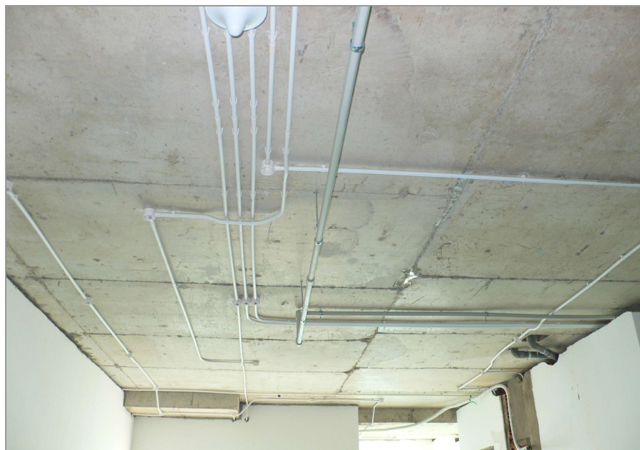
Hệ thống ống M&E cố định trên trần bê tông.
