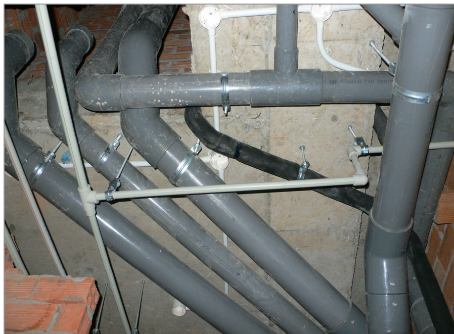
Hệ thống ống M&E lắp trên trần toilet.
