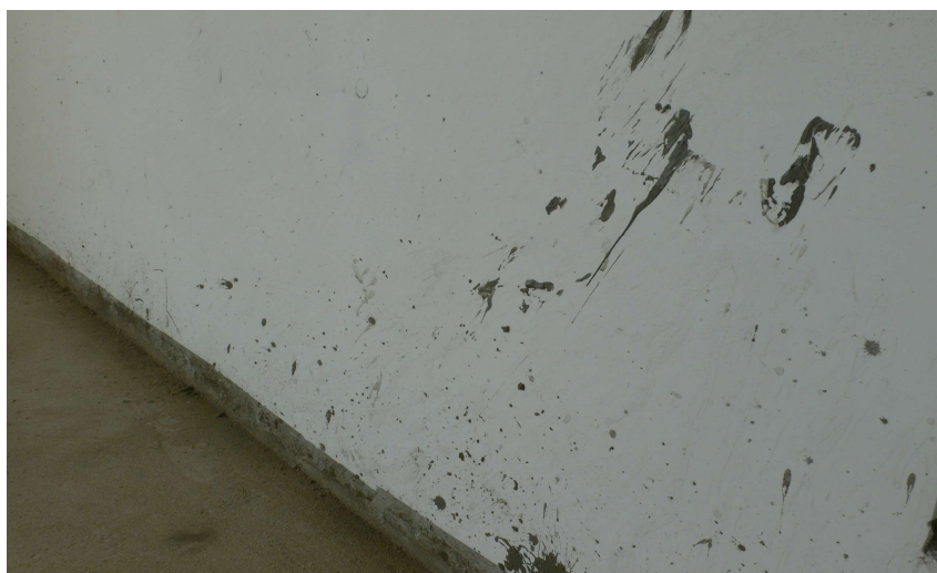
Không căng bạt ni lông che chắn, vữa cán bắn bẩn tường.
