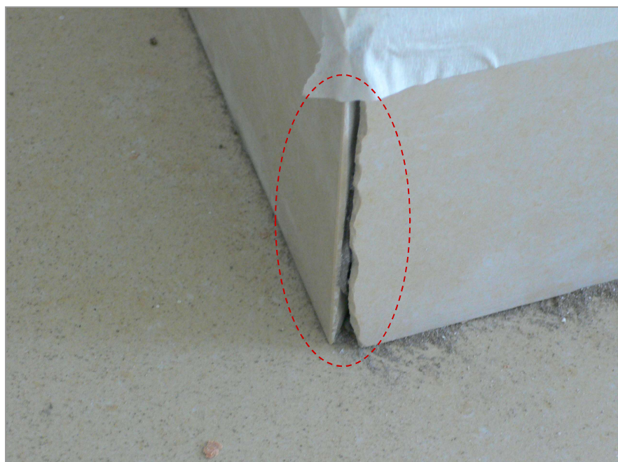
Cạnh góc lên chân tường bị mẻ. Mạch (join) lớn.
