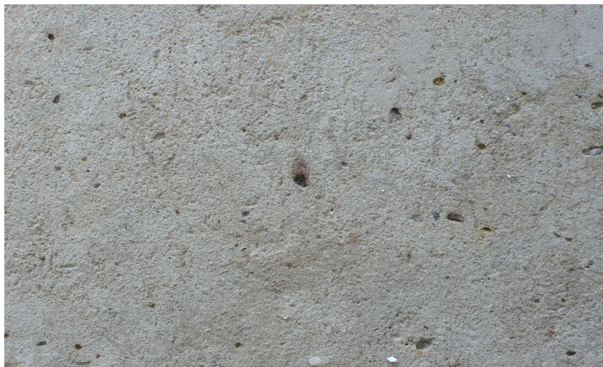
Mặt sàn bị rỗ do cát bắn lẫn trong vữa.
