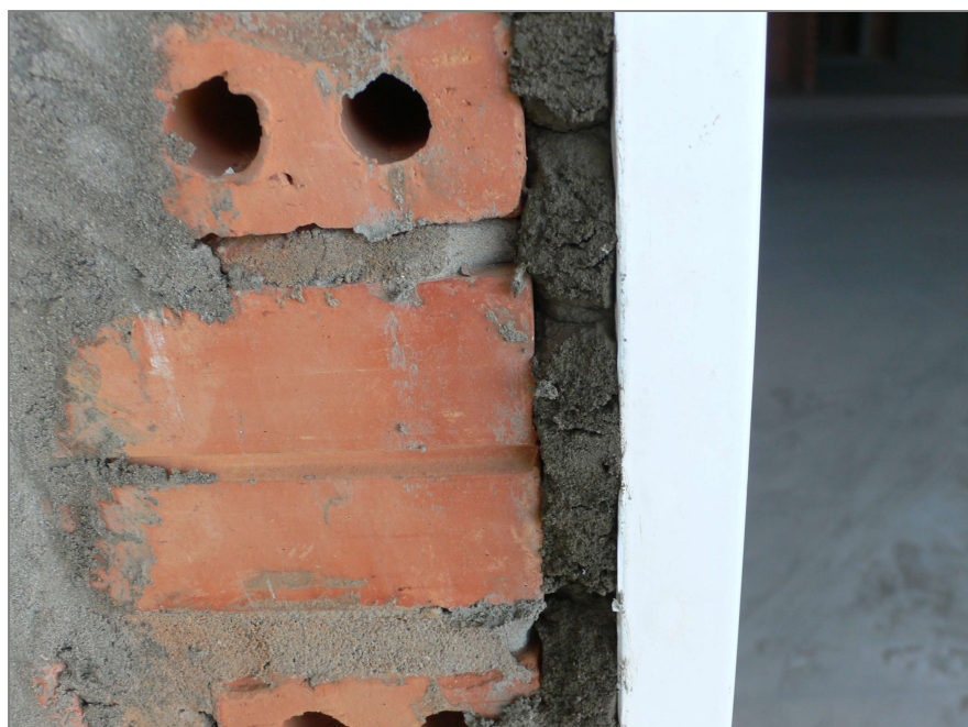
Khe phải được chèn kỹ ,tránh mưa tạt thấm .
